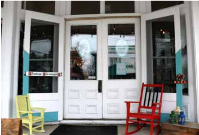
Portes en bois à double battant d'un ancien magasin général sis au 290, rue Masson à Sainte-Thècle.
