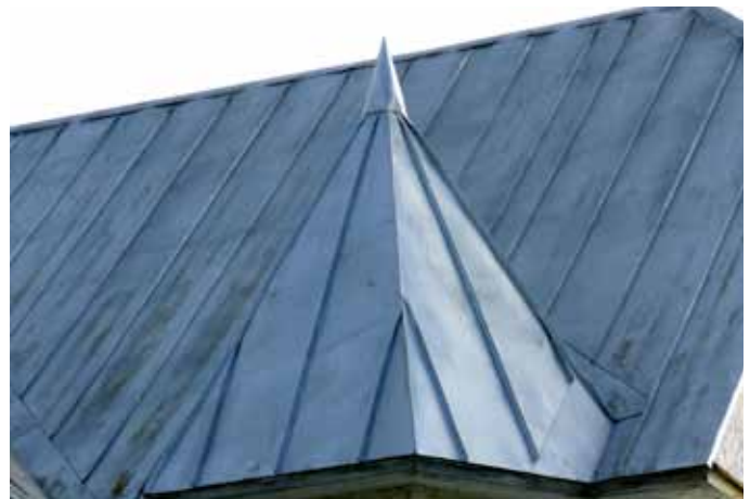
Tôle pincée sur une maison sise au 100, rue du Pont à Notre-Dame-du-Montauban.
