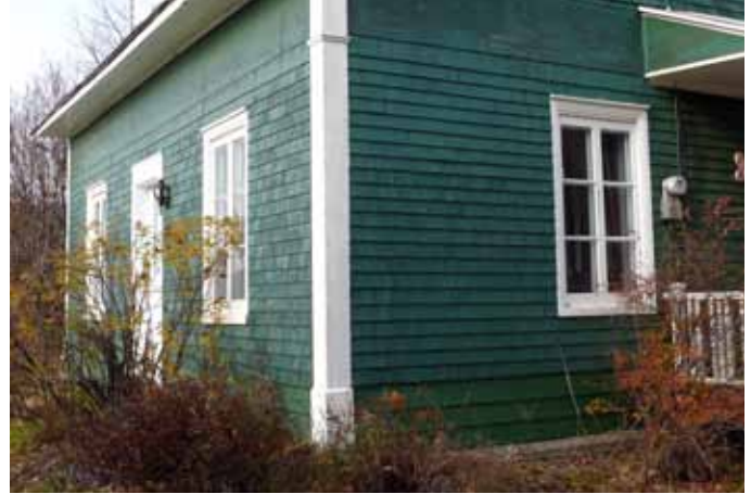
Planche cornière de couleur blanche sur une maison sise au 721, rue Saint-Alphonse à Lac-aux-Sables.
