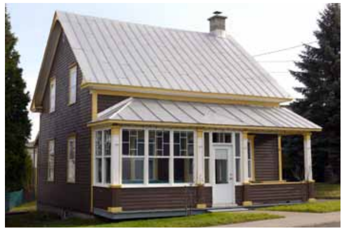
Tôle pincée sur une maison sise au 450, rue Saint-Jacques à Sainte-Thècle.
