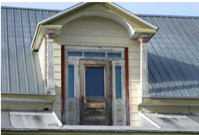
Imposante lucarne s'ouvrant sur le balcon d'une maison sise au 761, rue Saint-Jacques à Sainte-Thècle.
