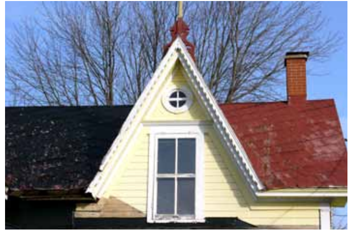
Fenêtre à charnières sur une maison sise au 211, rue Notre-Dame à Saint-Tite.
