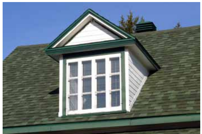
Lucarne avec fronton triangulaire sur une maison sise au 1031, rang Saint-Pierre à Hérouxville.
