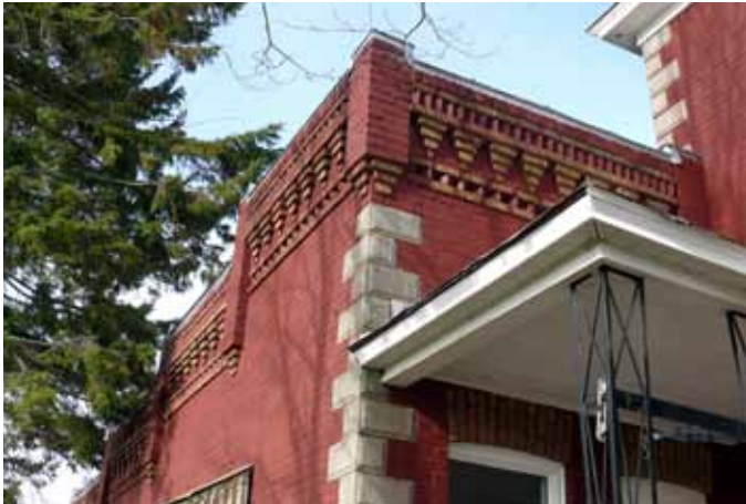
Revêtement en brique peint en rouge avec ses magnifiques jeux de briques sur une maison de Sainte-Thècle sise au 2391, chemin Saint-Pierre Nord.
