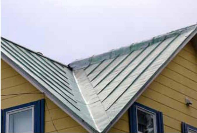
Tôle pincée sur une maison sise au 930, rue Principale à Lac-aux-Sables.
