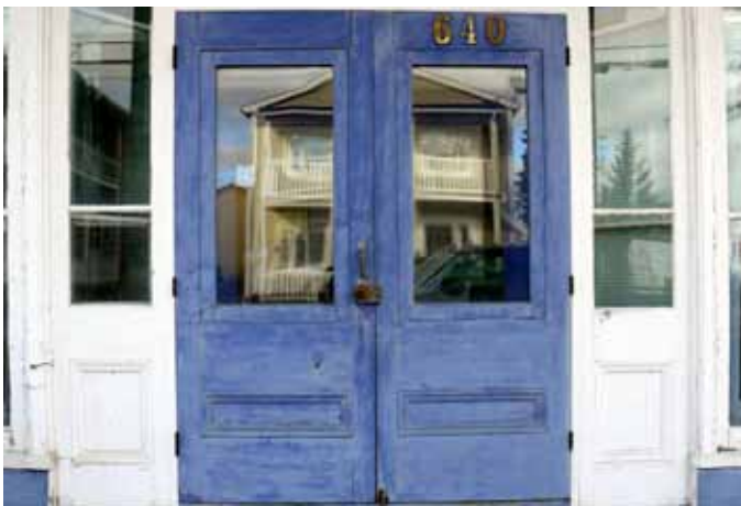
Portes en bois à double battant de l'ancien magasin général Lafontaine, sis au 640, rue Principale à Saint-Adelphe.
